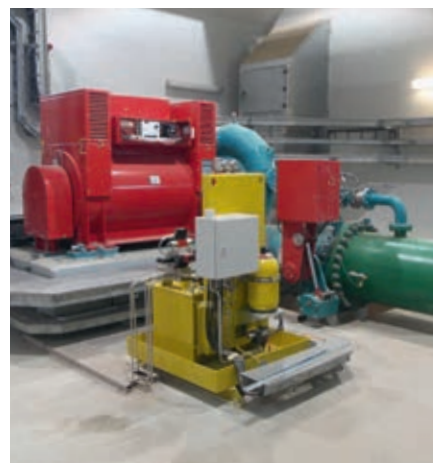
Réception sur site du groupe d'As Samra II, 400 kW, Jordanie
