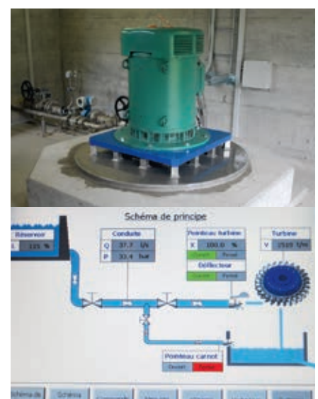
Développement et suivi du projet de turbinage des eaux du village de St-Jean – Val d'Anniviers, 105 kW, Suisse
