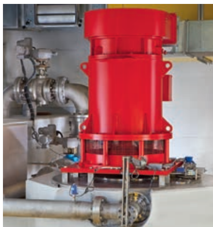
Turbinage des eaux usées de Verbier, 365 kW, Suisse
